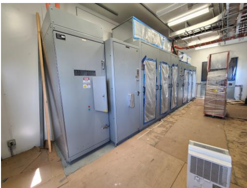
6500 HP 6900 Volt Siemens VFD
