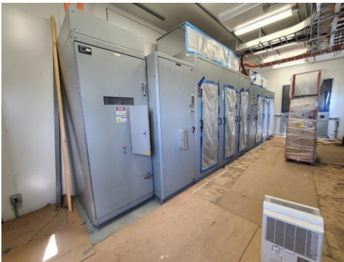
6500 HP 6900 Volt Siemens VFD
